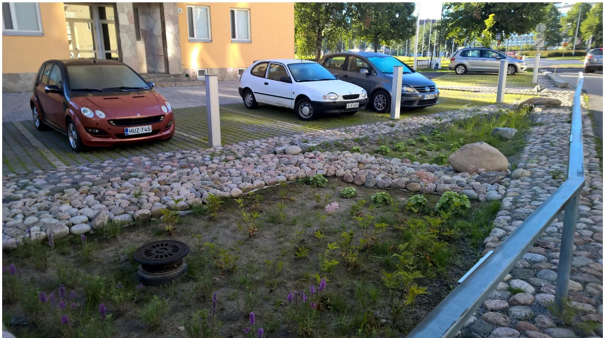
Kuva 12: Pysäköintialueelle toteutettu hulevesien laadullisen hallinnan rakenne.
