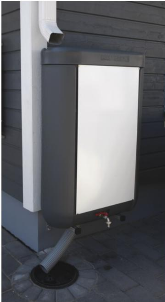
Kuva 13: Kattovesien kerääminen säiliöön (Kuva: Rakentaja.fi).
