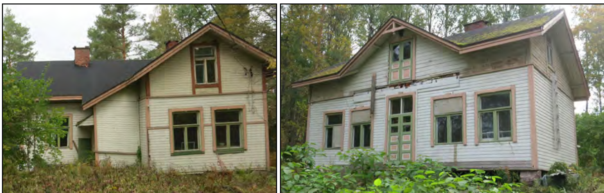
Rakennuksen perustukset ovat pahasti painuneet. Rannan puoleinen kuisti on purettu.
