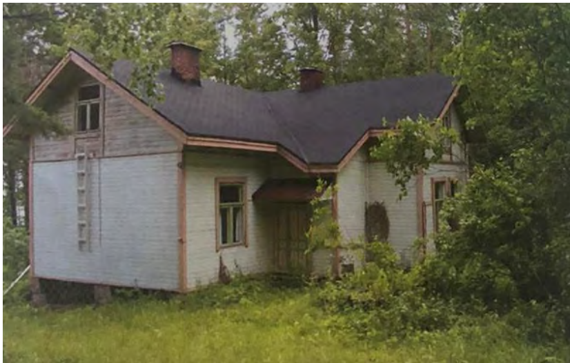
Kaavaselostuksen (2008) kuvaus rakennuksesta: Asuinrakennuksessa ei asuta ja se on heikkokuntoinen
