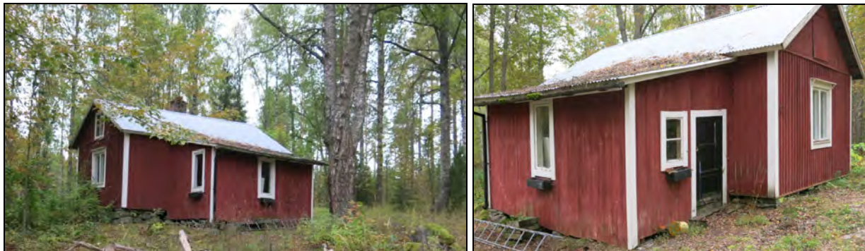
Pitkää asumattomana ollut asuinrakennus lienee rakennettu 1910-luvulla sen jälkeen, kun Hietamäen tila oli erotettu Mikkolan emätilasta.
