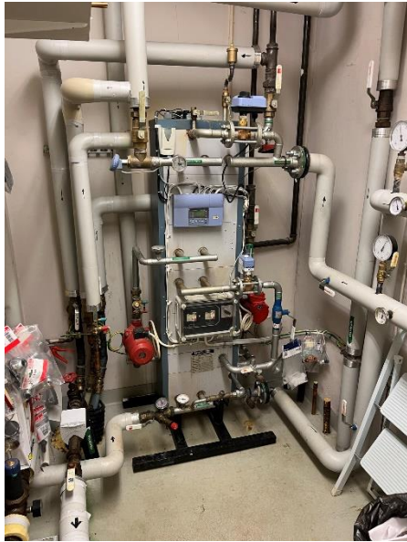
Kaukolämmönalajakokeskus on pääosin alkuperäinen ja uusimisen tarpeessa.
