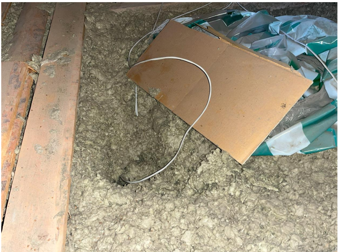
Sähkön muutostöiden jäljiltä yläpohjassa on roskaa ja puhallusvillaan kaivettuja reikiä johtojen kohdalla. Johdot vedetty villan päälle.
