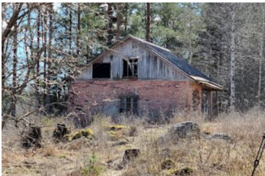
Kuva 32. Kuva Luotoniemen mahdollisesti arvokkaasta rakennetun kulttuuriympäristön kohteesta, joka osoittautui purkukuntoiseksi rakennukseksi.
