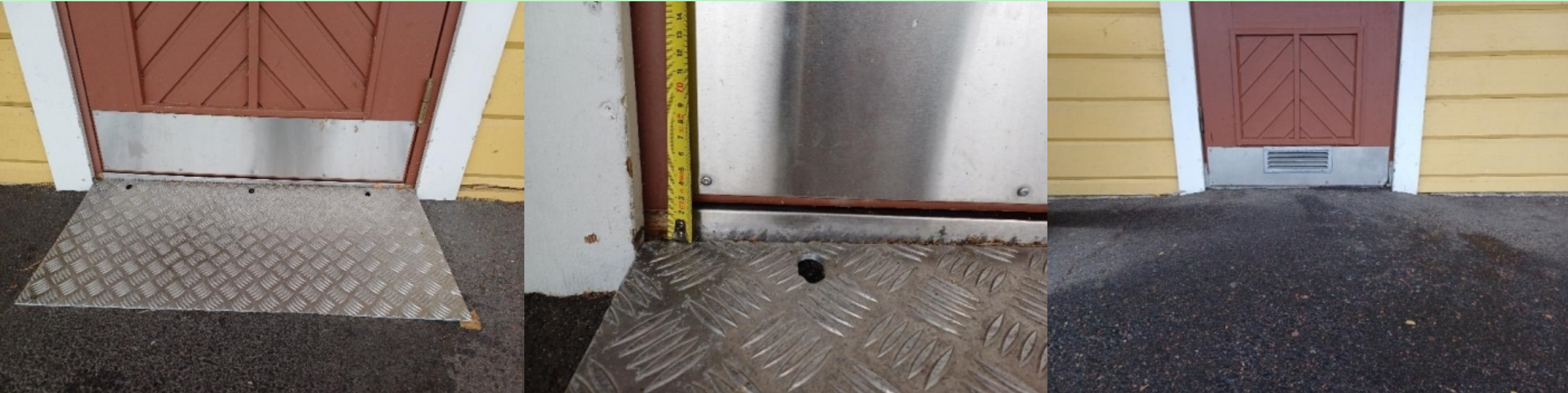
Kuva 1. & 2. Majakkapaviljongin sisäänkäynnin luiska on vinossa ja siitä puuttuu suojarieuna. Luiskasta huolimatta ovella on kynnyks.
