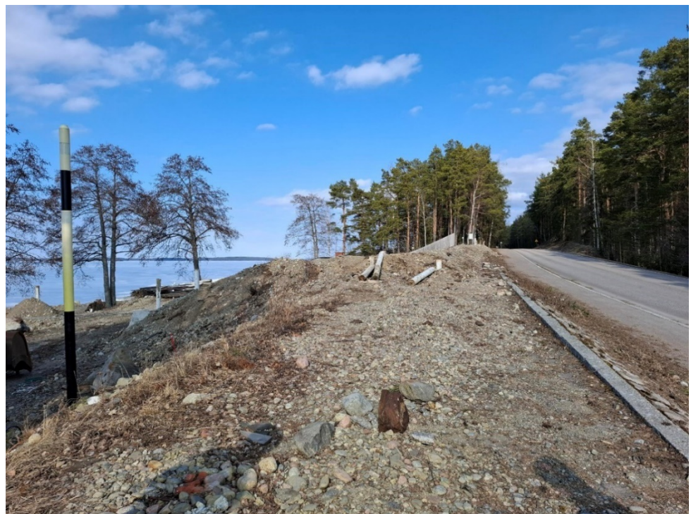
Kuva 3. Tarkastuksen päättyessä sähköpylväät on katkaistu, reimaria ei ole poistettu, koska sijaitsee kiinteistöllä 16-413-20-1.
