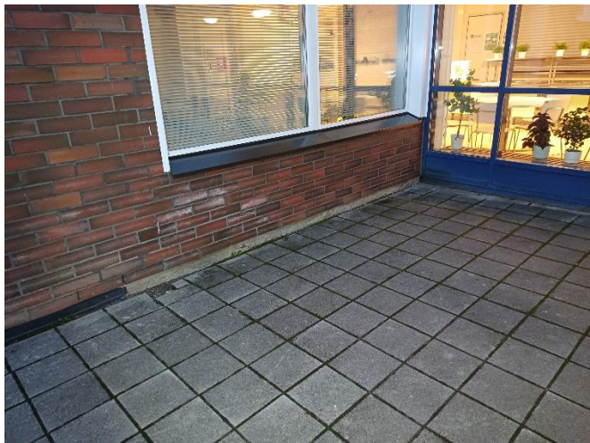
Kuva 4 Julkisivussa kosteusrasituksen aiheuttamaa maalipinnan irtoilua
