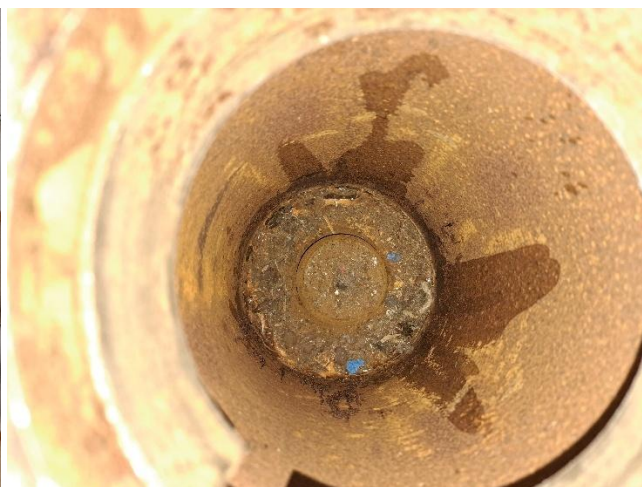
Kuva 17 Liikuntasalin tolpan syvennyksessä kosteutta
