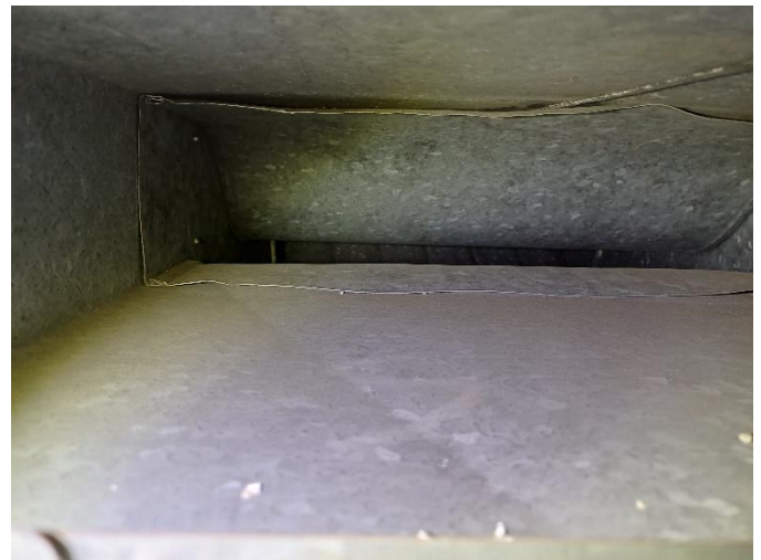
Kuva 47 Tuloilmakanavassa jonkin verran pölykertymää, tila 028.
