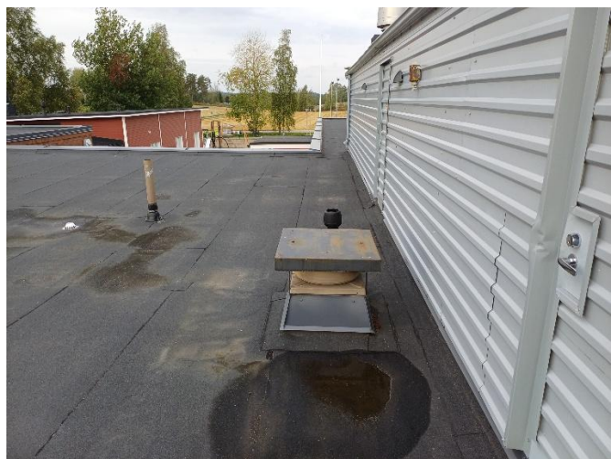
Kuva 9 Lammikoitumista iv- konehuoneen edessä
