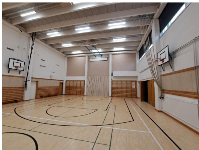
Kuva 16 Liikuntasali, yleiskuva. Tilassa tunkkainen hajua
