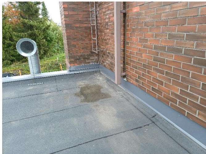
Kuva 7 Yleiskuva vesikatto, paikoin lammikoita vesikatteen päällä
