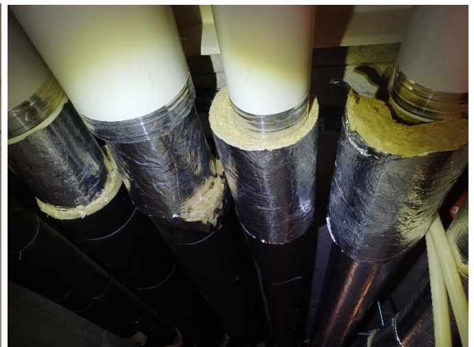
Kuva 24 Putkieristeiden päitä on teippaamatta
