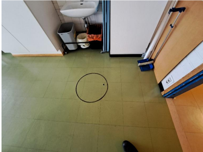
Kuva 21 Luokan lattiassa tekniikkaluukku
