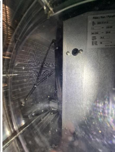
Kuva 30 Ilmanvaihtokoneissa ei mineraalivillaisia äänieristeitä
