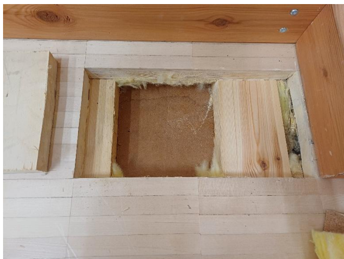
Kuva 36 Liikuntasalin lattiaan kovalevyssä vesijälkeä
