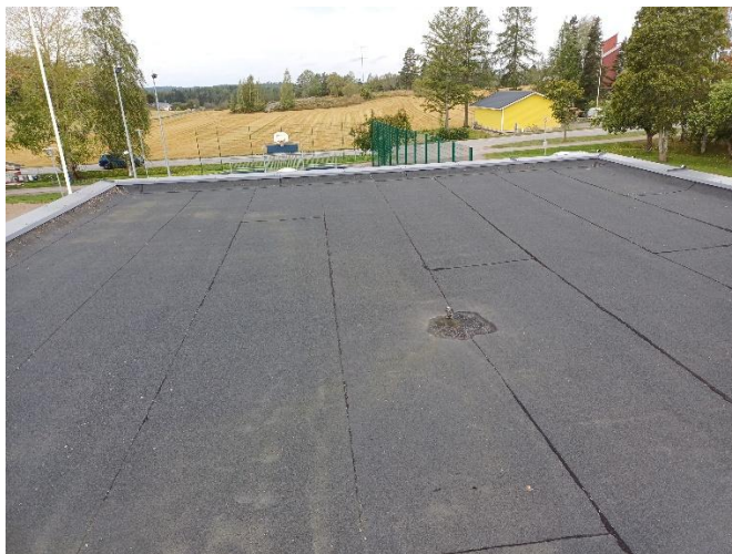
Kuva 8 Lammikoitumisen jälkiä vesikatteen päällä
