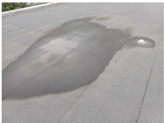
Kuva 5 Yleiskuva vesikatto, paikoin lammikoita vesikatteen päällä
