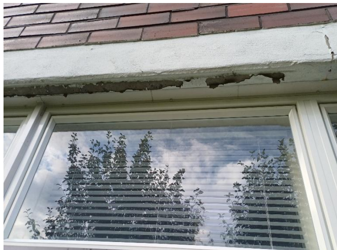
Kuva 3 Julkisivussa ikkunan leukapalkissa rapaumaa
