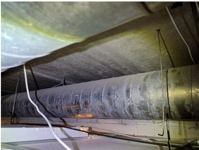
Kuva 27 Luokkien edessä IV kastunut ennen asennusta/ pölyä
