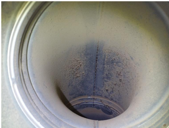
Kuva 46 Poistoilmakanavassa runsasta pölykertymää
