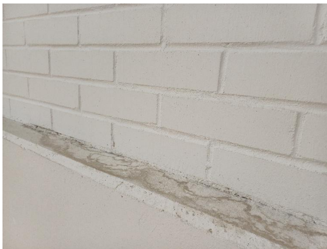
Kuva 19 Liikuntasalin ikkunoiden alla vanhoja kosteusjälkiä
