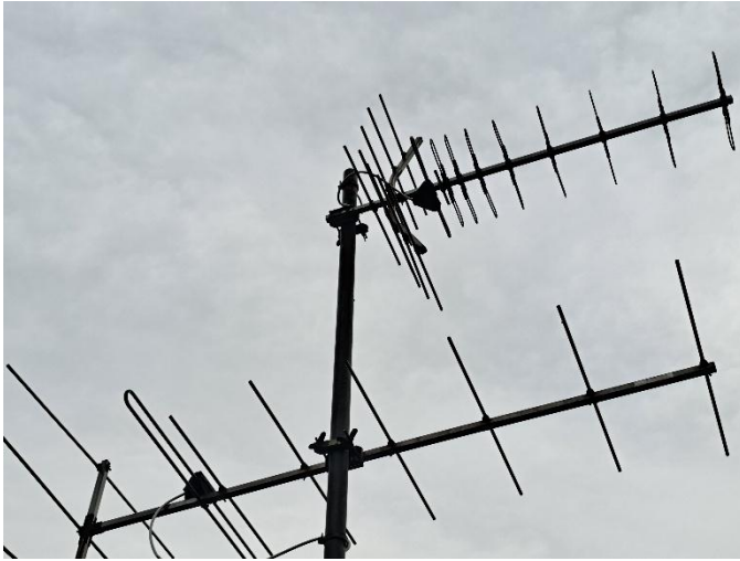
Kuva 15 Liikuntasalin katolla olevasta antennista puuttuu tulppa
