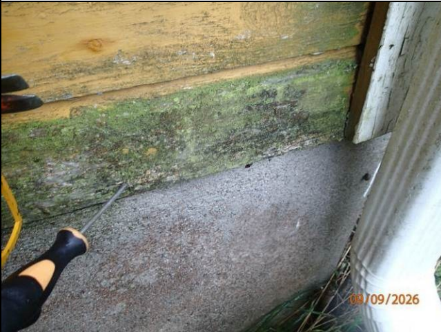
Kuva 13 Sisäänkäyntikuistilla on lahoa.
