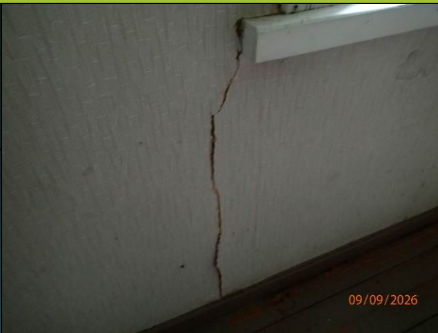
Kuva 42 Repeämä yläkerran päätyseinässä.
