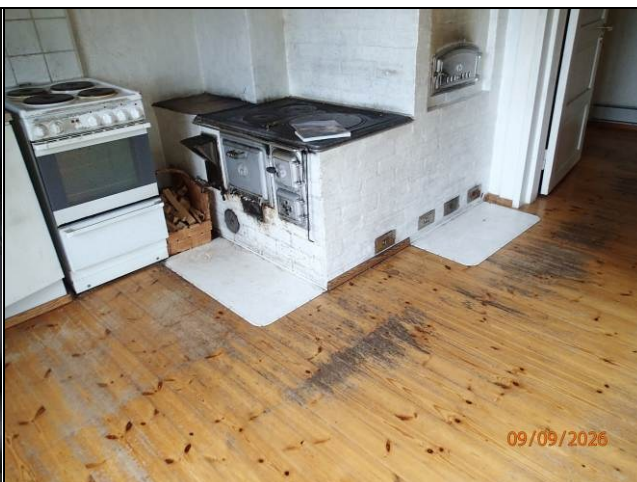
Kuva 38 Lattialaudoituksessa on kulumaa.
