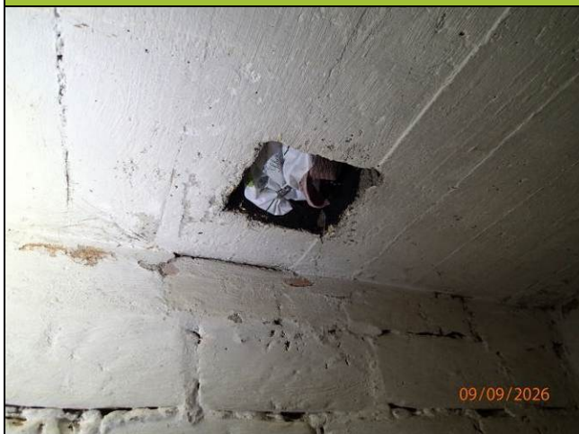
Kuva 43 Varaston katossa oleva poistohormi oli tukittu tarkastushetkellä.
