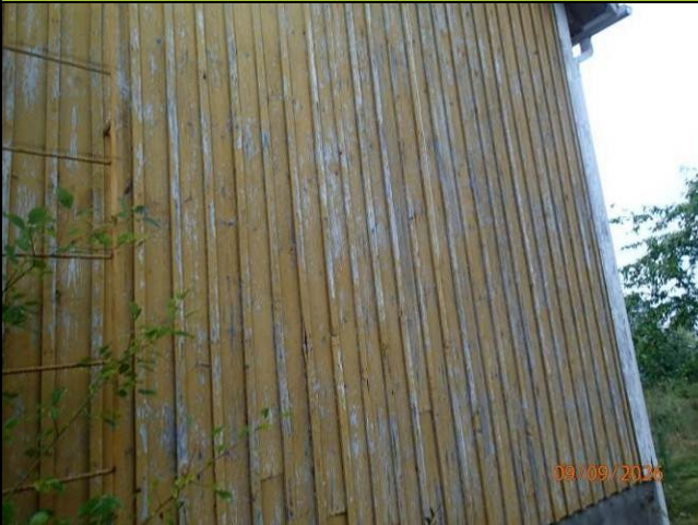
Kuva 11 Julkisivuverhouksen maalipinnat hilseilevät.
