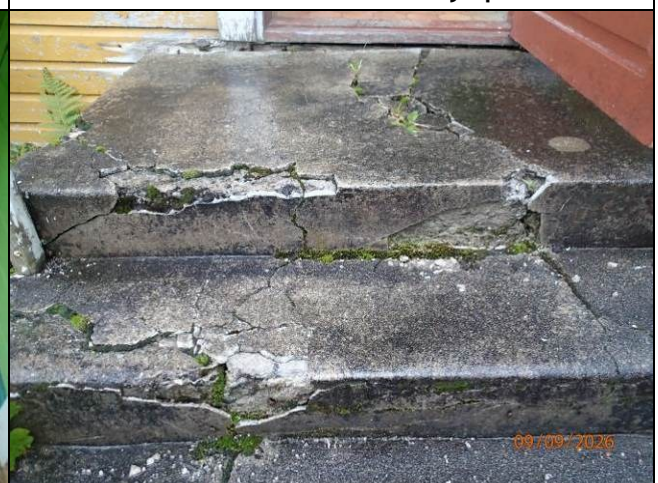
Kuva 16 Portaiden pinnoite on vaurioitunut.
