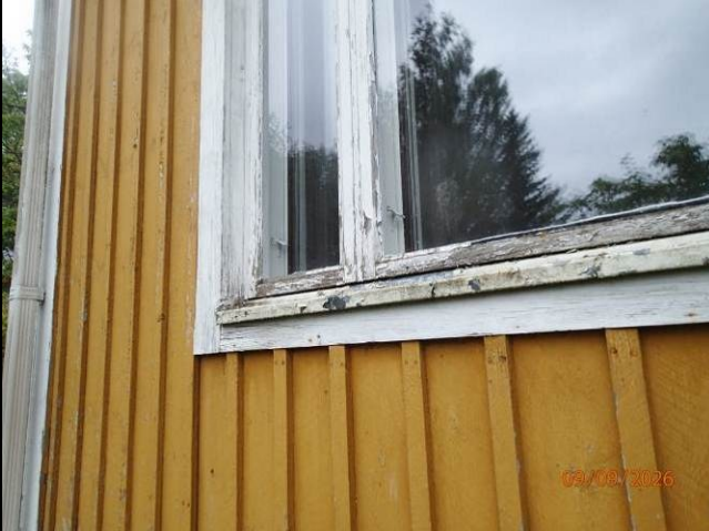
Kuva 17 Ikkunat ja vesipellit ovat uusinnan tai kokonaisvaltaisen huollon tarpeessa.
