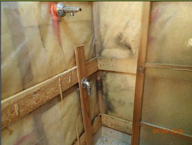
Kuva 32 Tummentumia pesuhuoneen seinien lämmöneristeissä (panelointi poistettu).
