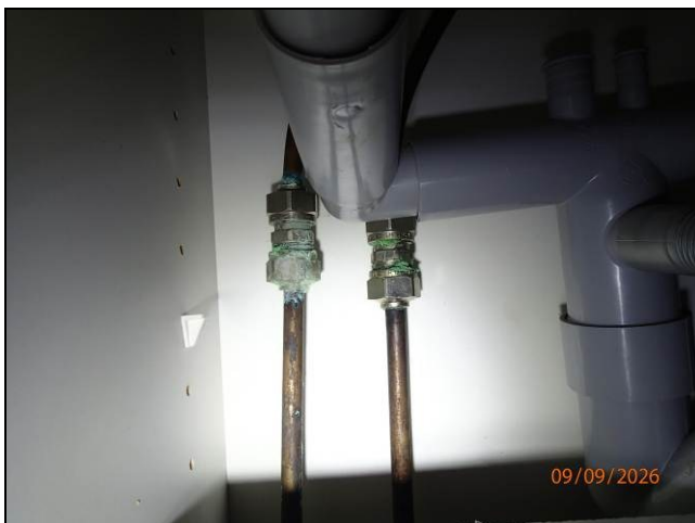
Kuva 37 Hapettumaa allaskaapin putkiliitoksissa.
