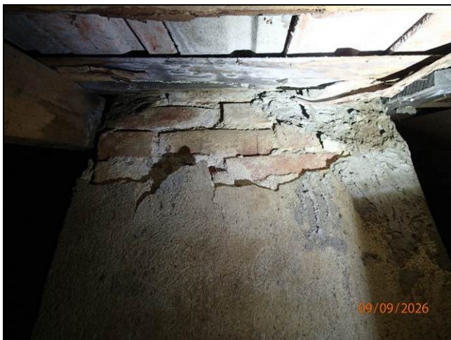
Kuva 29 Hormin pinnoite on irronnut. Kattorakenteet ovat paikoin kiinni hormissa.
