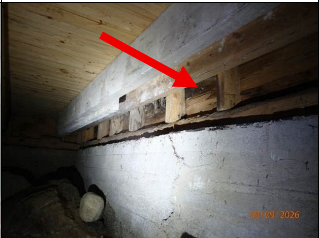
Kuva 8 Tummentuneita puurakenteita sisäänkäyntikuistin ja portaiden välissä.
