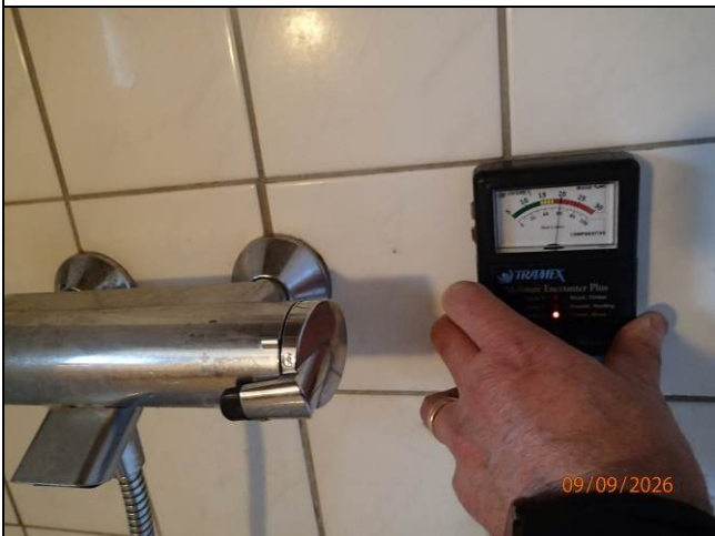
Kuva 33 Koholla olevaa kosteutta suihkunurkan seinälaatoituksen taustalla.
