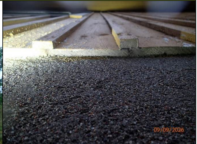
Kuva 12 Julkisivuverhouksen alareunassa ei ole tuuletusrakoa.
