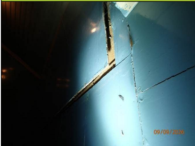
Kuva 41 Seinälevyn kiinnitys on osittain irronnut yläkertaan johtavassa portaikossa.
