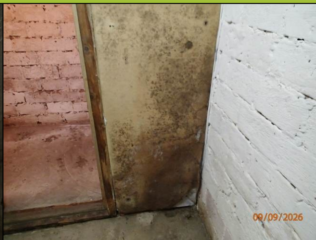
Kuva 44 Varaston levyseinät ovat vaurioituneet.
