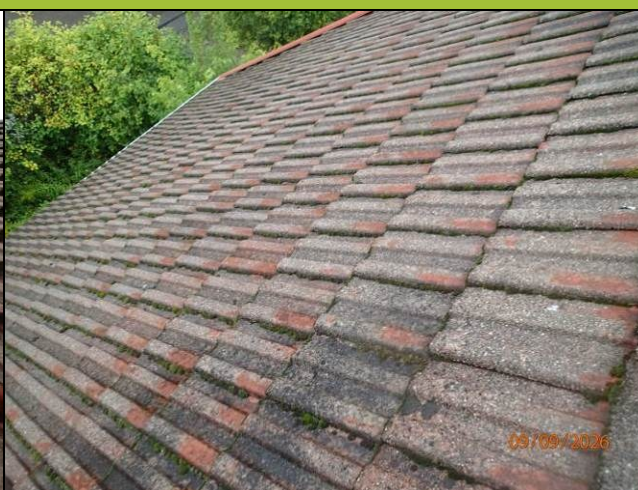
Kuva 22 Tiilikatteessa on runsasta rapautumaa.
