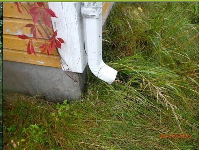
Kuva 10 Kattovedet imeytyvät rakennuksen nurkille.
