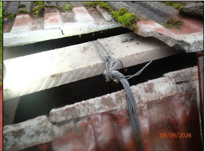
Kuva 24 Lapetikkaiden yläpää on kiinnitetty rautalangalla.
