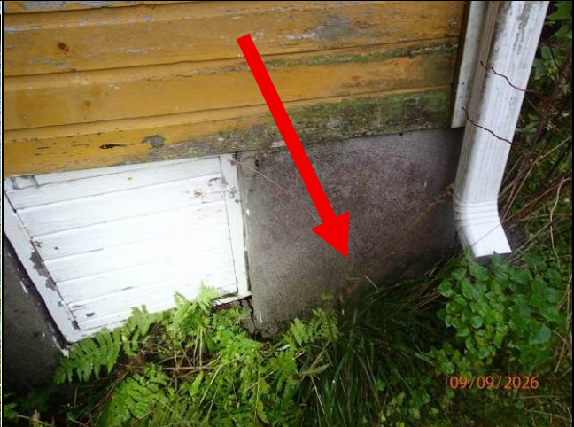
Kuva 6 Sisäänkäyntikuistin perustus on pettänyt.
