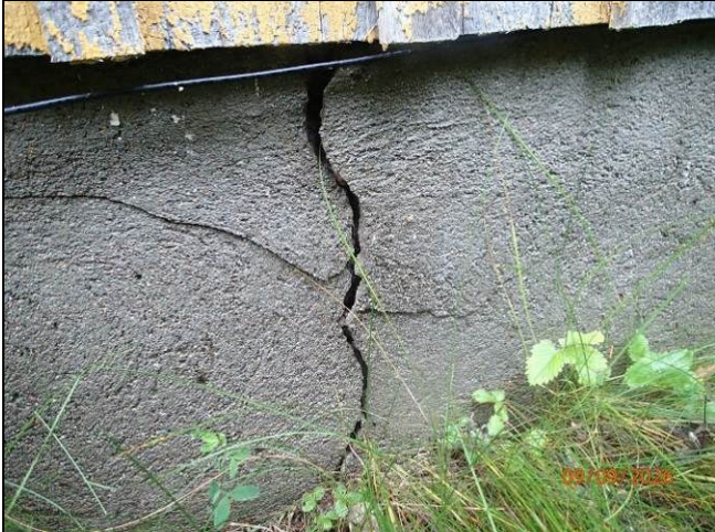
Kuva 5 Halkeama perusmuurin pinnoituksessa.
