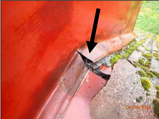
Kuva 25 Vuotokohta piipun juuressa.
