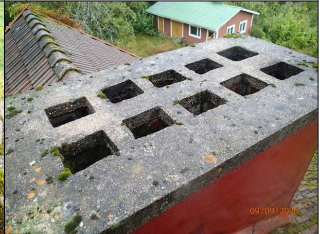
Kuva 26 Piipun päällä ei ole sadehattua.
