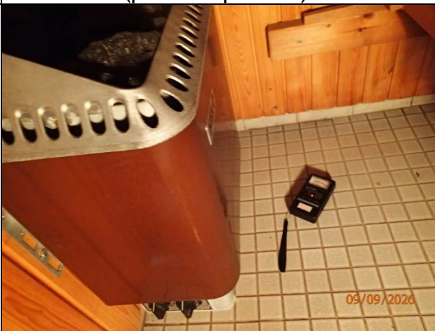
Kuva 34 Koholla olevaa kosteutta kiukaan alapuolella.
