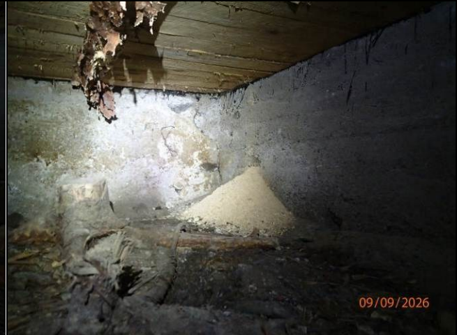
Kuva 2 Alapohjan eristepuraa on valunut ryömintätilaan.
