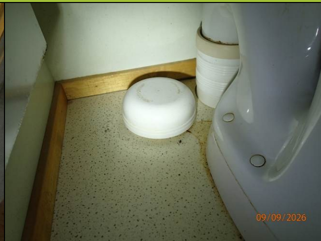
Kuva 40 Alipaineventtiilin juuressa on vanhoja kuivuneita valumajälkiä.
